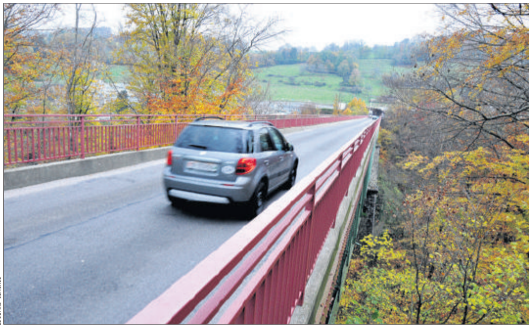
SÉCURITÉ ACCRUE Outre la réhabilitation totale du tablier, très endommagé, le viaduc de Fenil sera équipé de barrières rehaussées. Donc moins facilement franchissables. Les travaux pourraient démarrer début avril. Et durer neuf mois. FENIL-SUR-CORSIER, LE 4 NOVEMBRE 2008
